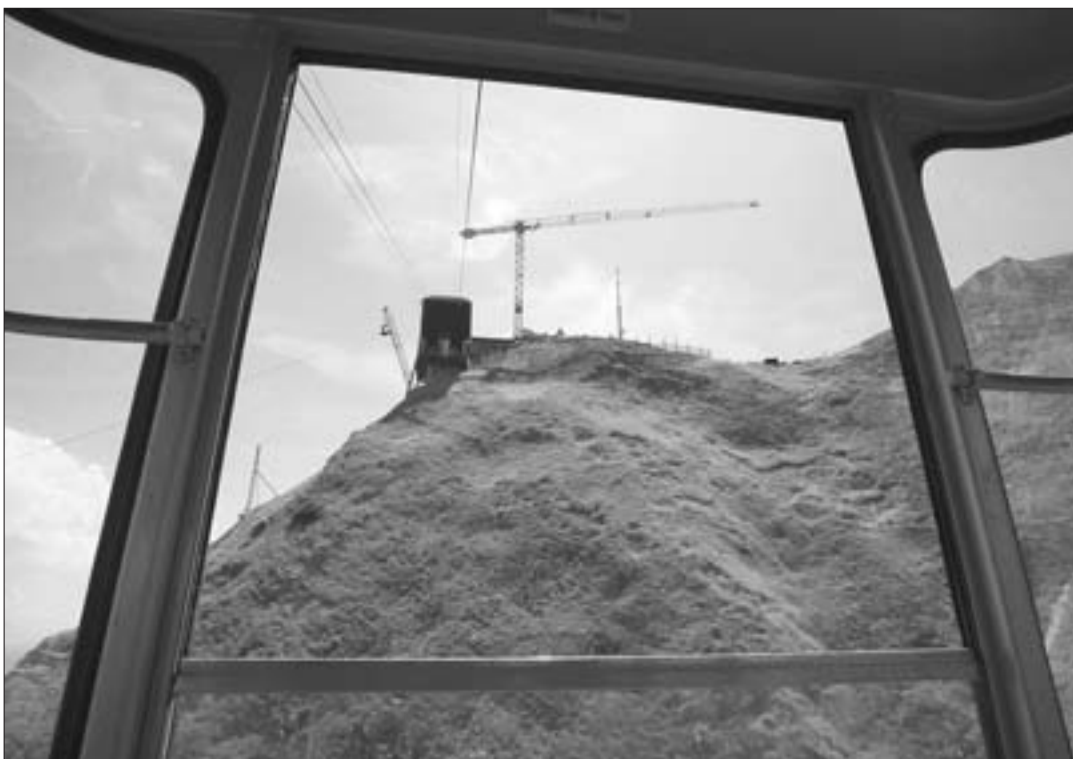
Installée à 1970 m d'altitude, la grue est capable de résister à des vents de 200 km/h.
